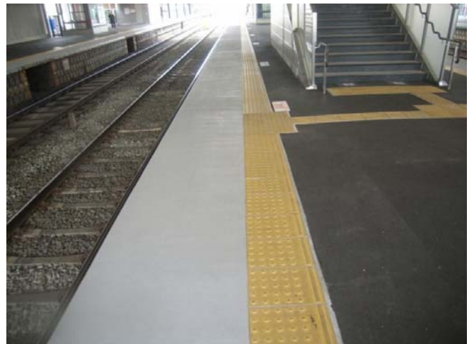
京王線 東府中駅 ホーム先端笠石ブロック部修繕工事 施工 2012年3月
