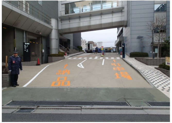
施工直後(2015年2月撮影) 全面撤去、下地処理ショットブラスト実施後に施工
